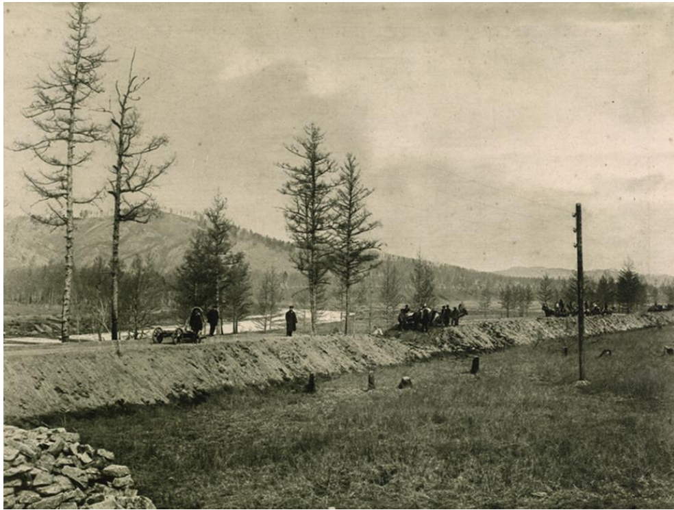
Рис. 4. Строительство западной части Амурской железной дороги, 1908–1913 гг. Возведение насыпи на 9-й версте [5]
